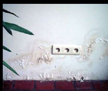
Mur humide avant traitement
